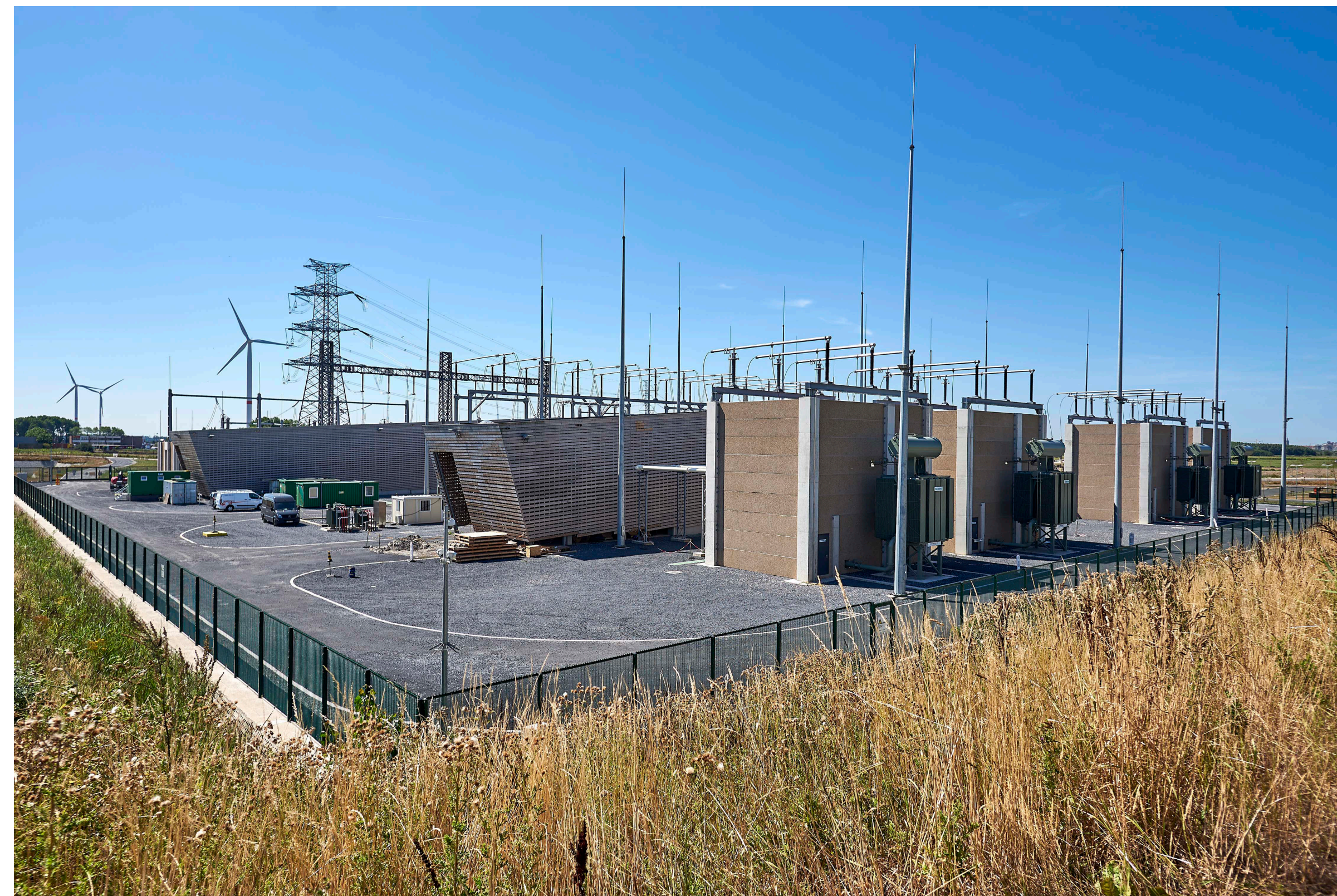
Foto bestaand hoogspanningsstation
