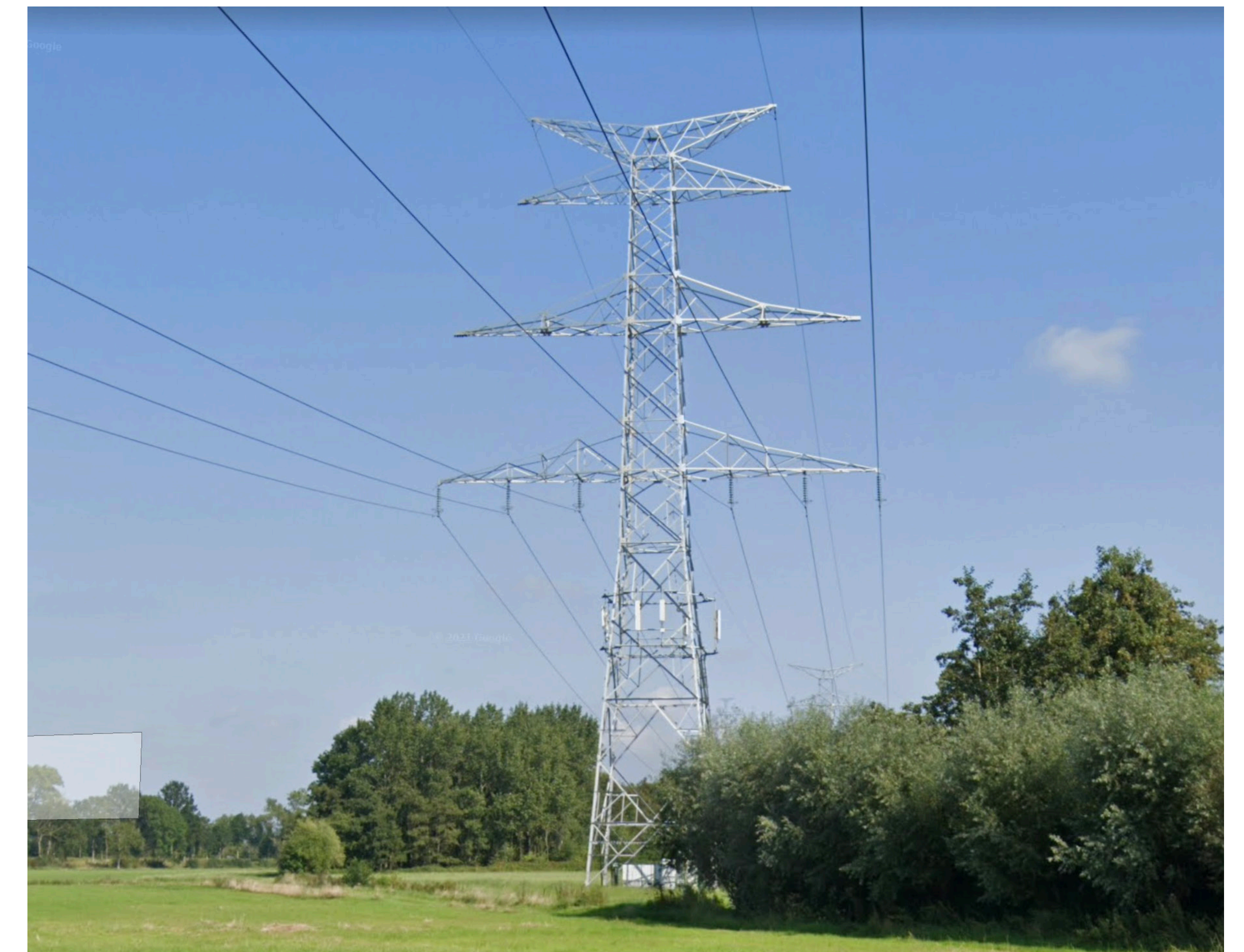
Beeld: Bestaande 150 kV-masten in bestaande toestand, zonder de bijkomende 380 kV-draadstellen.
